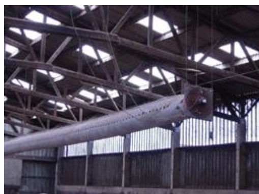
Figure M14.1. Gaine de dispersion et de mélange du gaz traceur dans le bâtiment (source : INRA)
